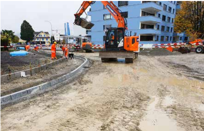
Trotz schwieriger Verhältnisse im November mit völlig durchnässtem Baugrund und überraschend aufgetauchten Mehrarbeiten konnte der Kreisel Lauerz rechtzeitig fertiggestellt werden.
