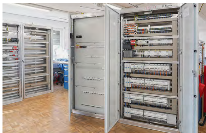
Schaltschränke, wie sie am Amstutzweg 4 in Kriens hergestellt werden.
