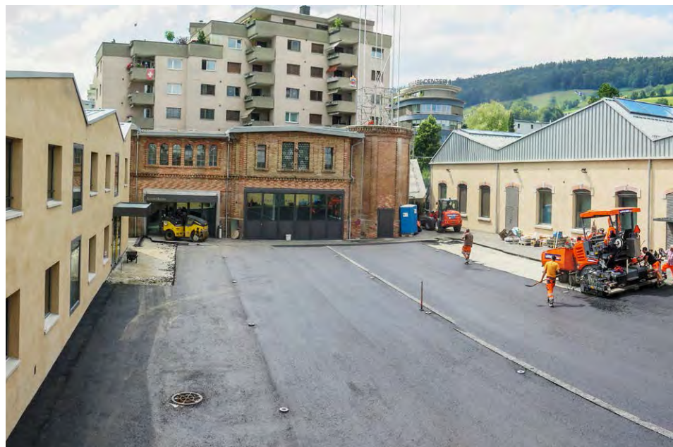
Der Innenhof nimmt Gestalt an: Von links Musikschule, Galerie und Saalbau aus der Per-
